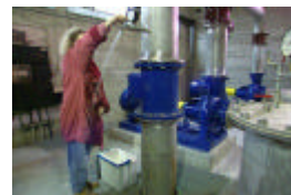
In den Wasserwerken wird die Qualität des Trinkwassers aus Quellen und Brunnenbohrungen regelmäßig überprüft.
